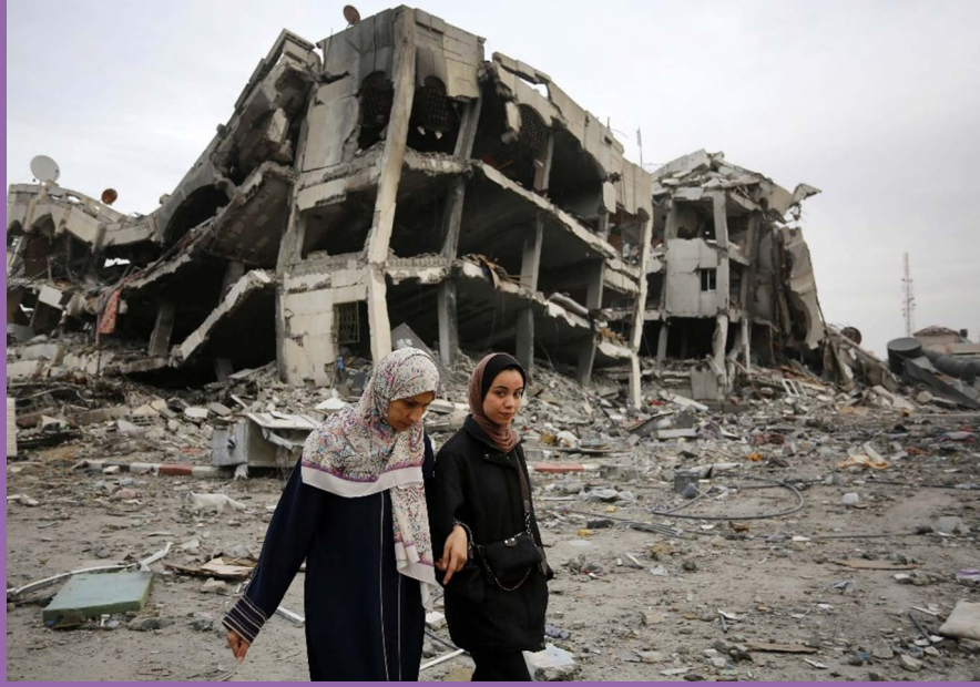
نوفمبر، أناس بين أنقاض المباني المنهارة جراء الغارات الإسرائيلية، مدينة غزة. © 2023، تصوير الأونروا، أشرف عمرة.
